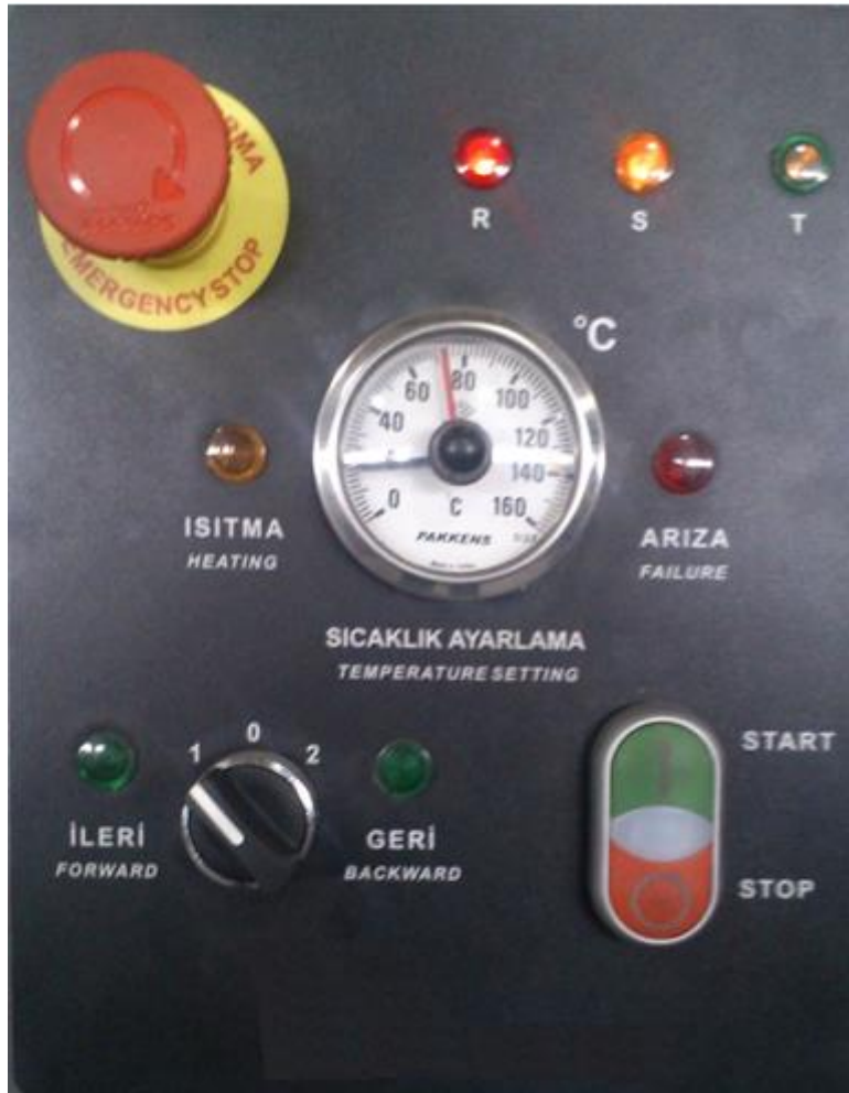
Şekil-2 Kontrol Paneli
