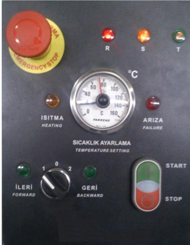
Şekil-2 Kontrol Paneli
